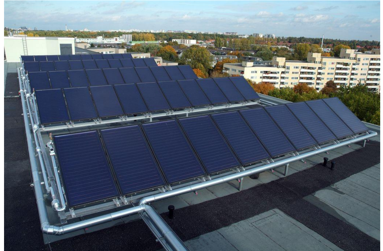
Quelle: BSW-Solar/ Upmann, Solarthermieanlagen auf einem Flachdach
