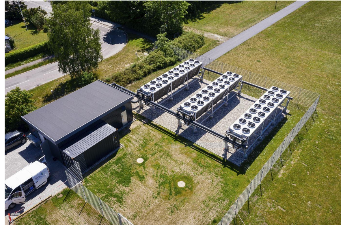
Quelle: PlanEnergi, 1 MW Luft-Wärmepumpe in Dänemark
